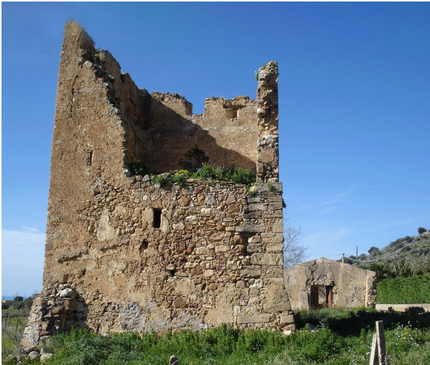
Fig. 33 - Il lato meridionale della Torre di Catrini: la foto attesta la ricostruzione della cosiddetta 'cantunera' e una importante integrazione del tessuto murario resa evidente dall'utilizzazione di materiale di forma e tecnica diverse da quello originale.
