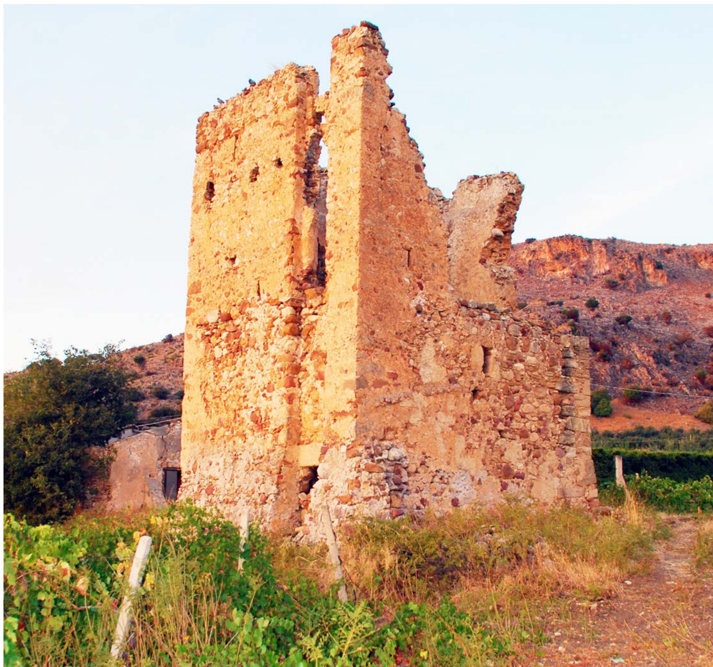
Fig. 27 - I lati ovest e sud della Torre di Catrini. Si notano, la caduta di una feritoia e appendici murarie.
